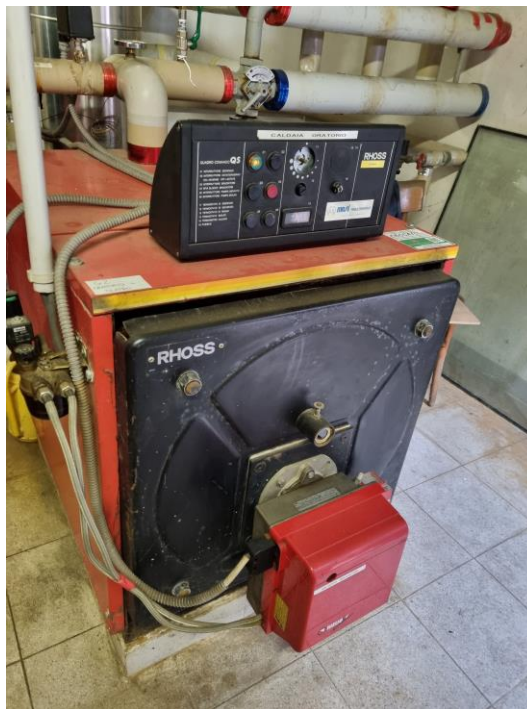
Immagine 6. Generatore termico teatro-oratorio
